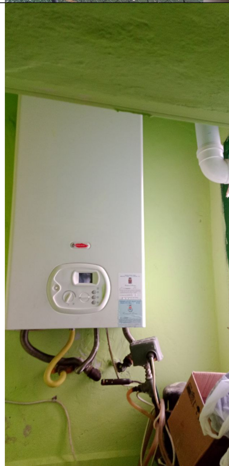
Caldaia locale tecnico
