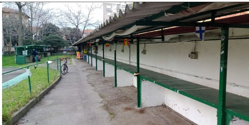
Ripiani manutenzione meccanica mezzi
